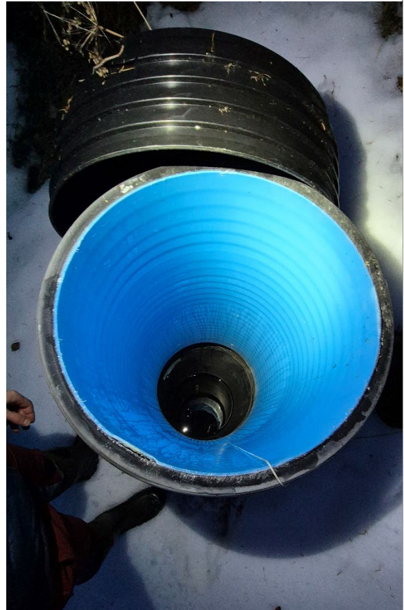
Figur 2-5: Kjøde 19-2. Gravdbrønn med overføringsledning til samleikum Kjøde 19.
